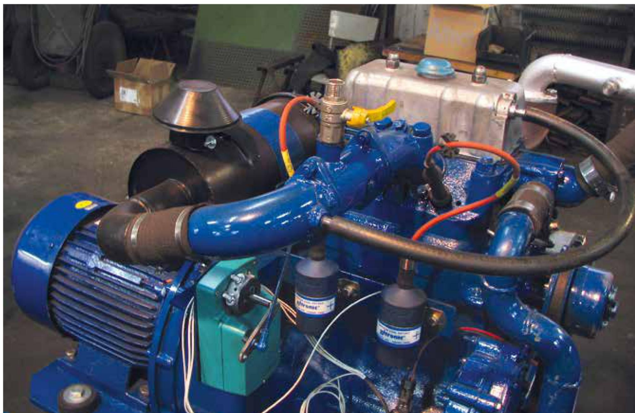
/ Zdjęcie 1. Kogenerator o mocy 10 kW (silnik Perkinsa i prądnica Celma Cieszyn).
